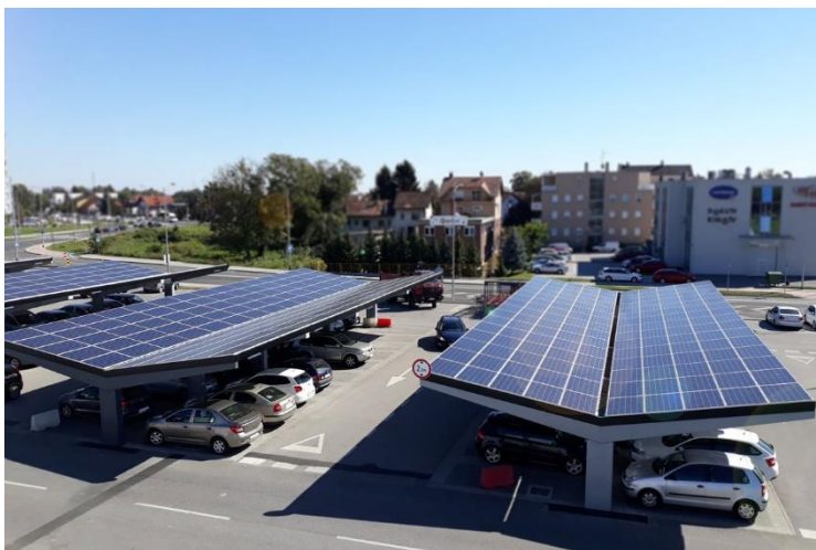
Beispiel eines Solar Carports (Quelle: www.sens-energy.com )
